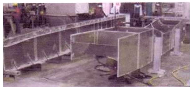
図 29 ハイブリッド溶接されるアルミニウム合金製船体構造 8.6)
